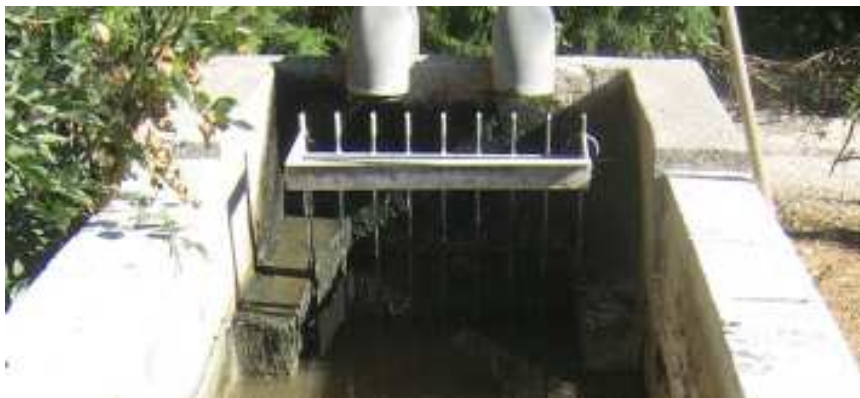
Dégrilleur de la station d'épuration
