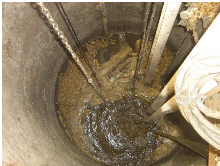
Poste de relèvement en entrée de la station d'épuration.
