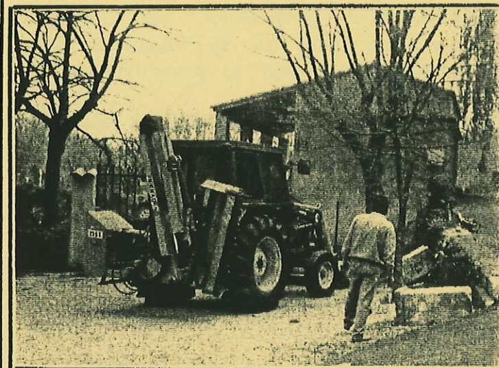
L'intervention du tracto-pelle municipal lors de l'éboulement du mur-rembarde prolongeant le club des Cigales.
